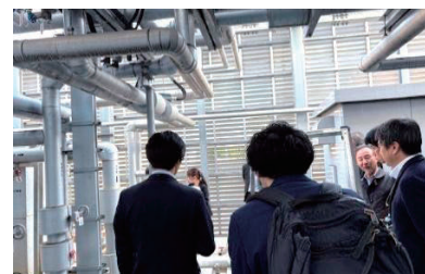
屋外機械設備スペース
