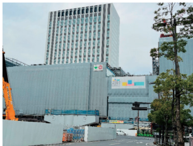
建設中の四代目駅舎。手前は 2 階に乗り入れる広島電鉄駅前大橋ルート の橋脚。奥にはホテル棟が見える (令和 6 年 2 月中旬撮影)
