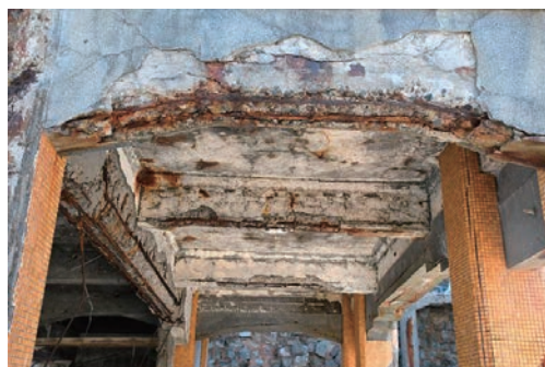
腐食鉄筋の劣化コンクリート
