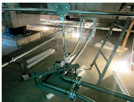
免震ゴム（左上部）
